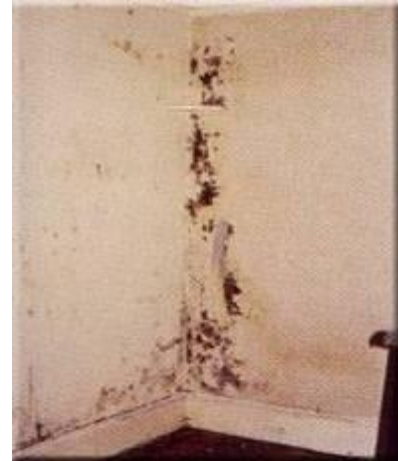
Schimmelwachstum in einer Kellerecke
